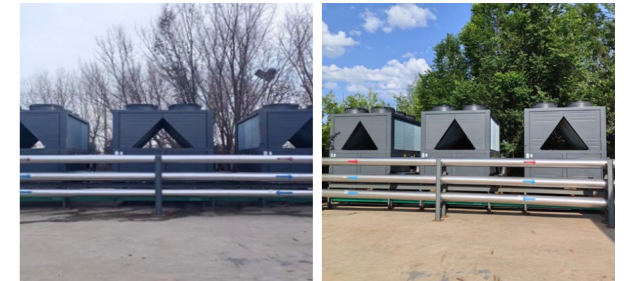
現代牧業賽罕牧場空氣能供暖設備
