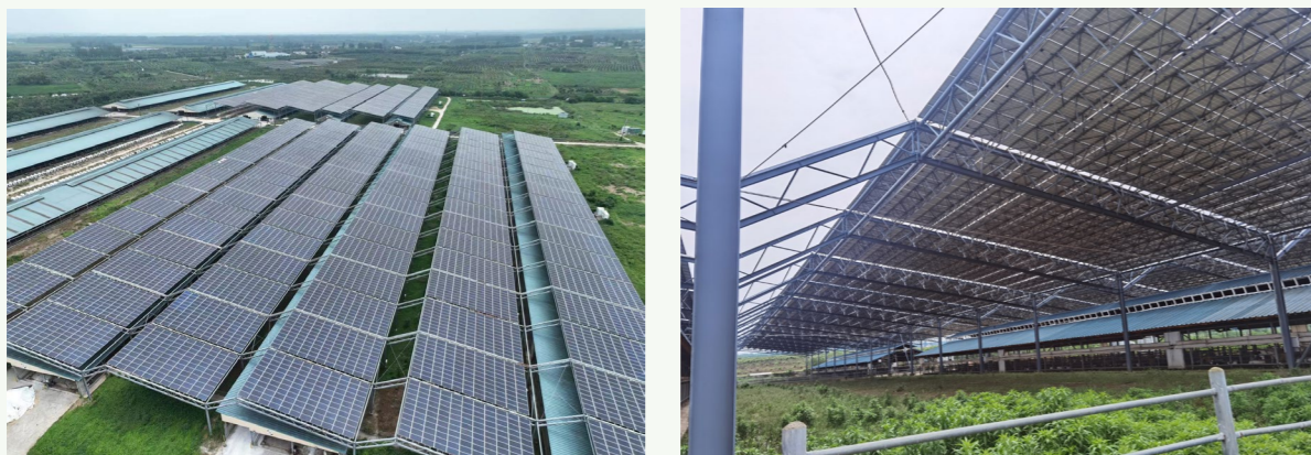
現代牧業所屬合肥牧場光伏發電站
